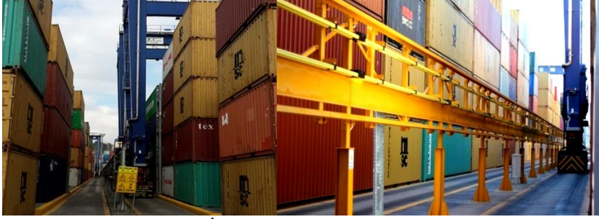
Şekil 2: E-RTG İçin Döşenen Baraların Görünümü Kaynak: Marport, 2015
